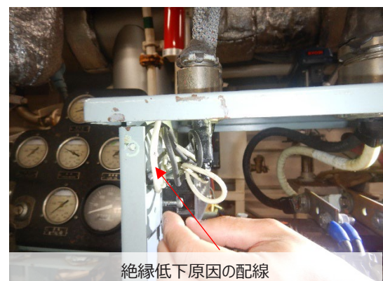
日本業者による 220V 絶縁低下の不具合特定作業
