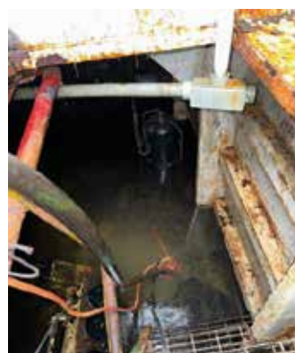
浸水した機関室
