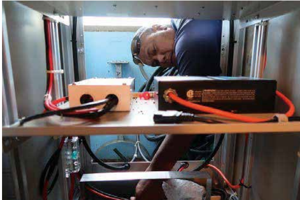
パラオ海上警察職員による電源関係機器の目視点検
