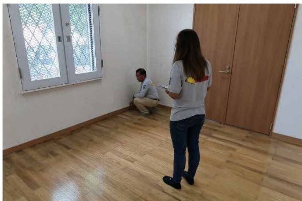
武道場床の傷み調査
