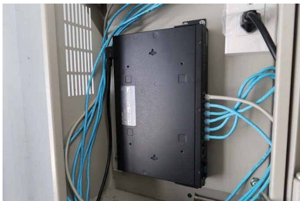
別館（既設棟）の LAN Hub
