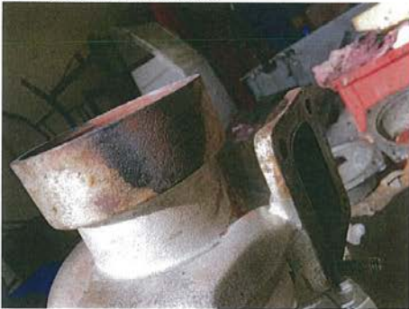
過給機出口管 漏れ点検
