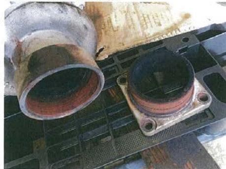
過給機出口管 漏れ点検
