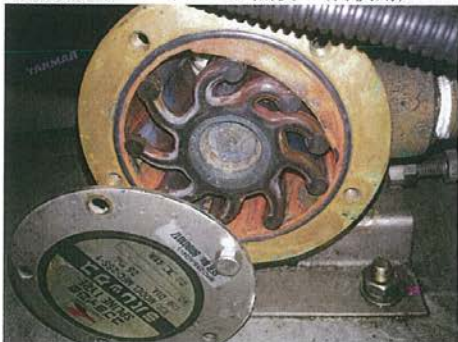
雑用海水ポンプインペラ点検（再使用）
