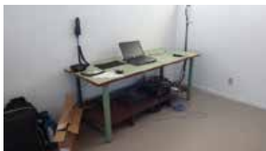
設置した無線装置
