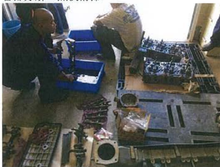
各部分解・点検清掃
