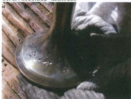
吸気弁腐食確認 全数交換
