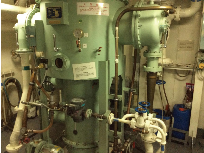
写真 3-2-19 造水装置（主機関の冷却清水を使用するタイプ）
