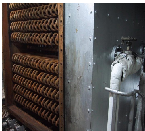
写真 3-2-14 排ガスエコマイザー
