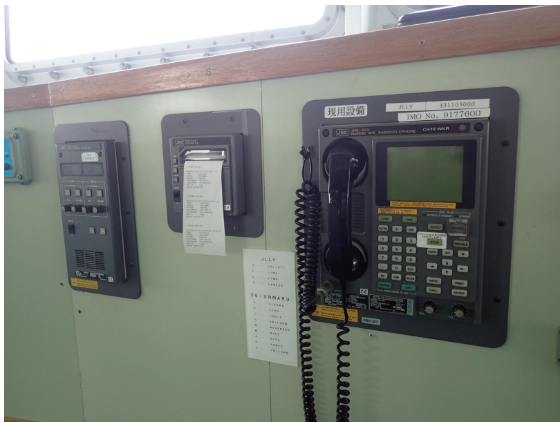
写真 3-1-31 国際 VHF 等の通信設備
