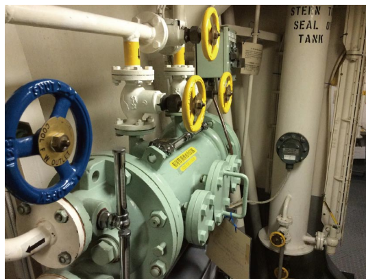
写真 3-2-17 船尾管軸封装置
