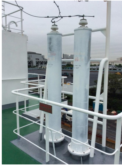
写真 3-1-30 アンテナ給電部
