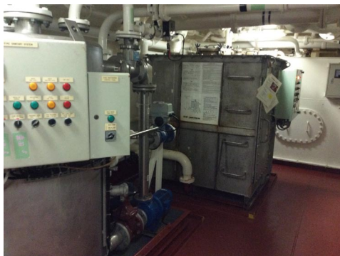
写真 1-1-2 污水处理装置
