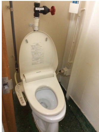
写真 2-1-2 寒冷仕様のトイレは加熱装置を作動
