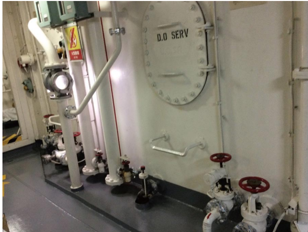
写真 3-2-4 ディーゼルオイル・サービスタンク
