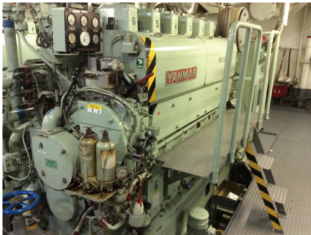
写真 3-1-21 ディーゼル機関 (発電機)
