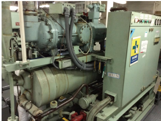
写真 2-1-10 船用空調装置
