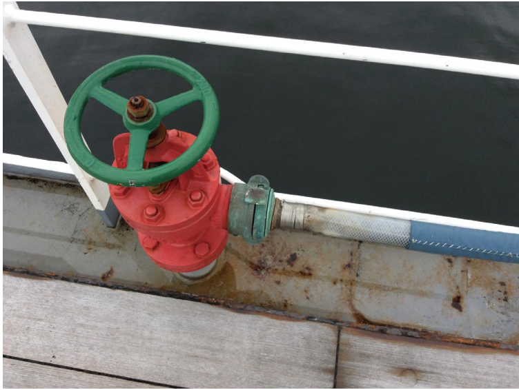
写真 3-1-18 防火操練後の消火ラインは水抜きを
