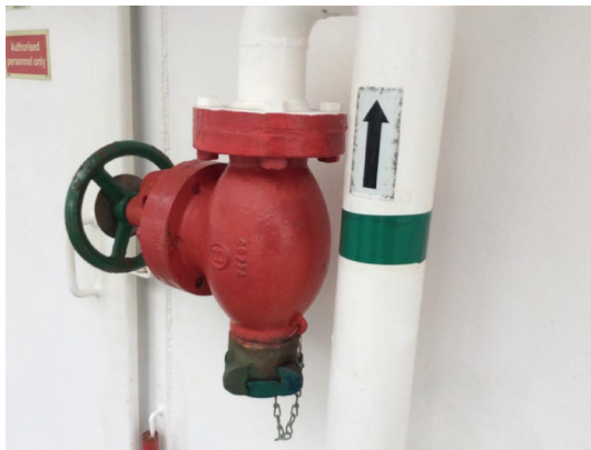
写真 3-1-11 甲板配管の水抜きを忘れるな
