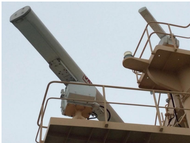
写真 3-1-7 アンテナ装置（輻射部及びペDESTAL部）
