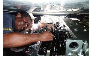
狭い機関室内での機関整備実習況
