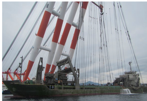
2016年大分佐伯湾で船体重量3000トンの作業船G丸を3700トン吊起重機船で吊り上げ撤去中
