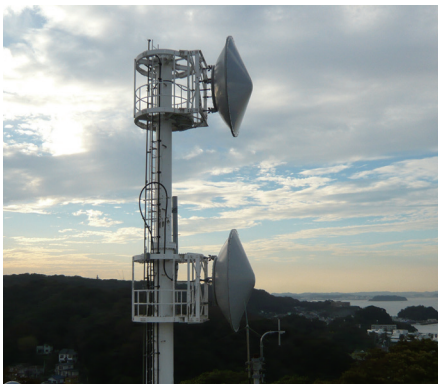
各地に設置されたレーダー局やAIS局からのデータを受信するため、塔以外にもアンテナが設置されているする管制官
