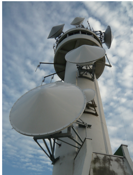
塔にはVHFやAIS・レーダーなどのアンテナが多数設置されている
