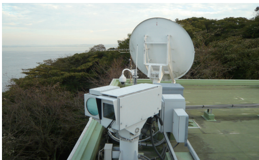
屋上に設置されている監視カメラ
