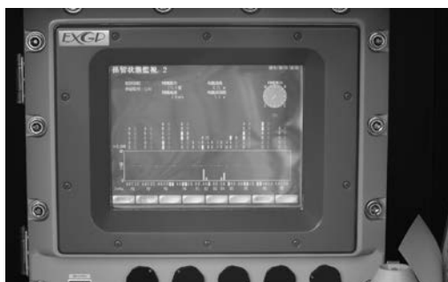
棧橋に設置されている係船索テンションモニター
