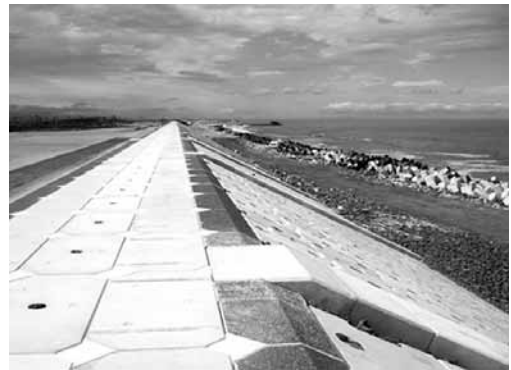
写真-3 急速に進む海岸堤防の復旧 出所：国土交通省東北地方整備局 HP
