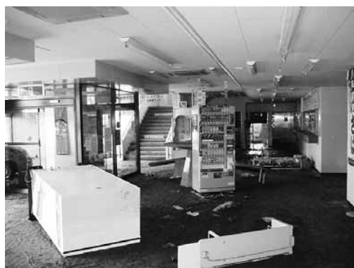
被害を受けたフェリーターミナルの待合室
