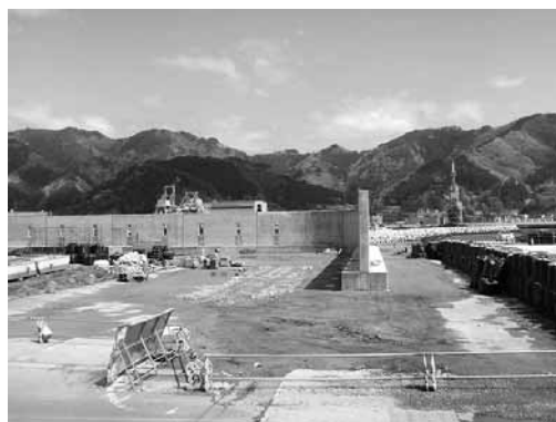
釜石港の防潮堤復旧状況 (岩手県県土整備部：平成26年5月2日撮影)
