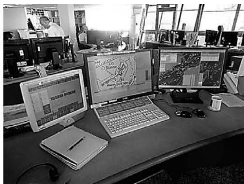
写真3 運用卓およびタッチパネル式通信装置
