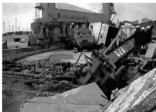
仙台塩釜港 高砂コンテナターミナル岸壁の荷役機械の損傷
