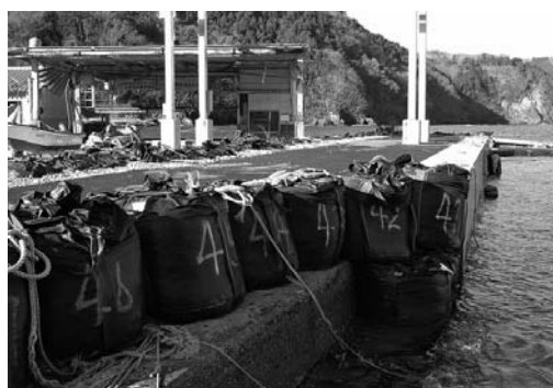
沈下した岸壁を漁師たちが有志で一部かさ上げして使用している。 船越漁港
