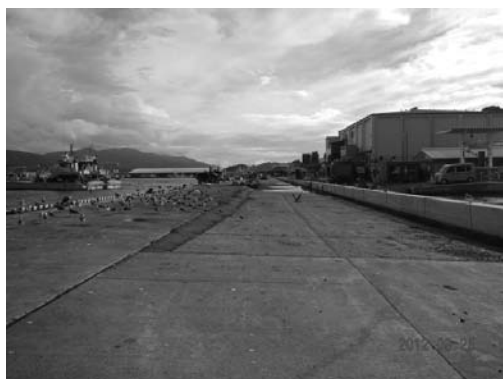
写真3：宮古港の応急的な防潮措置
