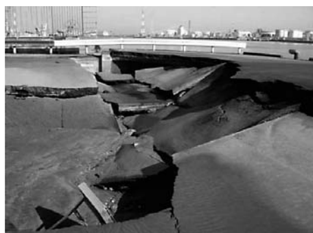
鹿島港 A 岸壁被災状況
