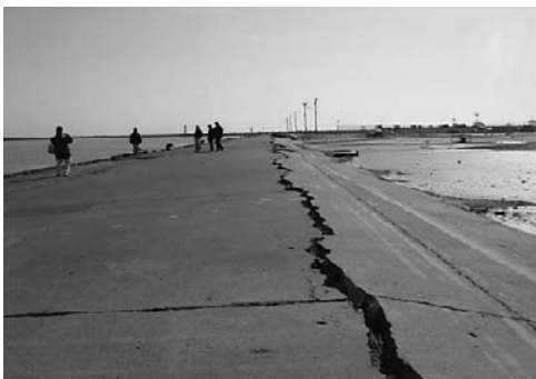
日立港区 B 岸壁被災状況
