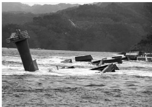
釜石港湾口防波堤被災状況
