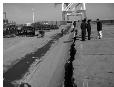
常陸那珂港区 B 岸壁被災状況
