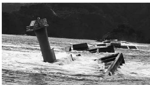
被災後の防波堤（北堤堤頭部）
