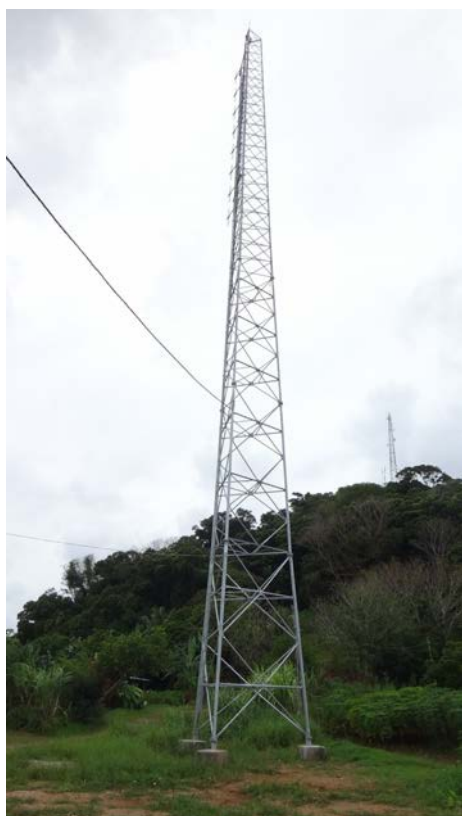
南部海域用 VHF レピータのアンテナ
