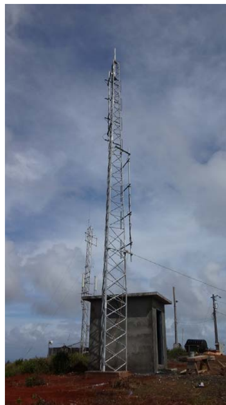
北部海域用 VHF レピータのアンテナ
