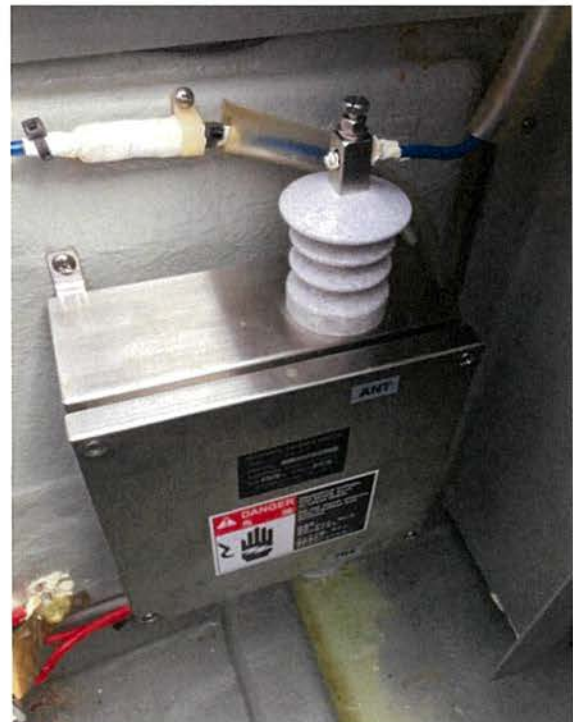
自動 ATN 切替器(AS-102)
