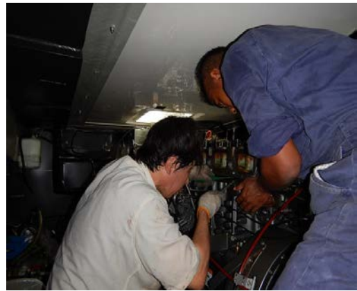
吸気ポートの確認・点検
