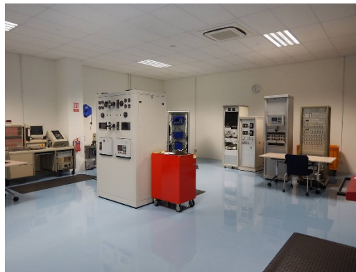
電気機器整備研修場
