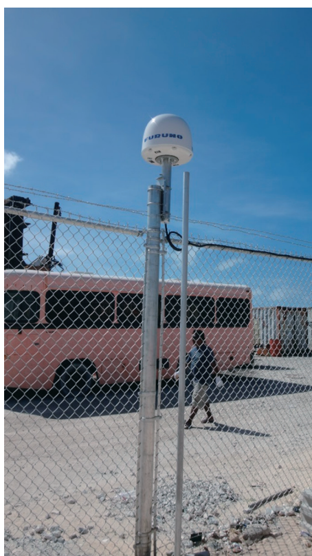
衛星通信アンテナ
