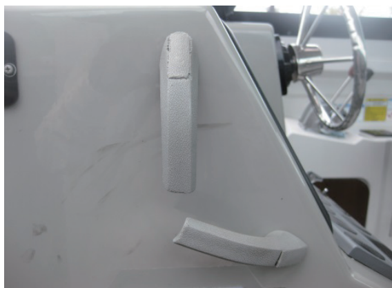
壊れたブレーカーパネルのスイッチ
