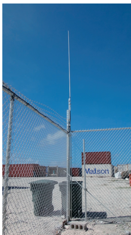
VHF アンテナ
